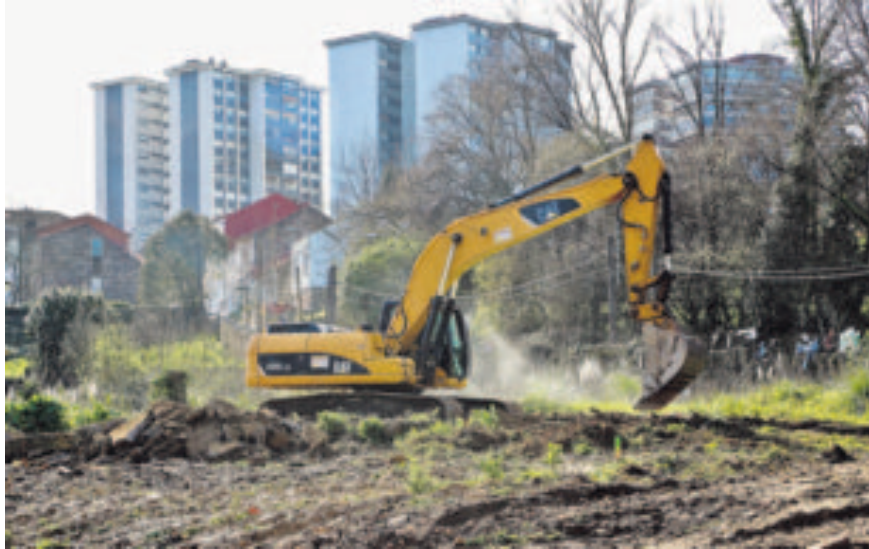
La excavadora ya está limpiando la finca de Tomas Alonso, que acogerá tres edificios. M. MORALEJO
